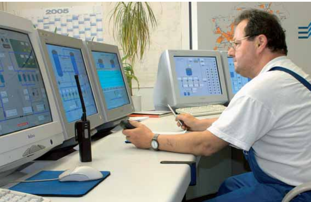
In den Leitzentralen laufen die „Nervenstränge“ für Trink- und Abwasser zusammen.
